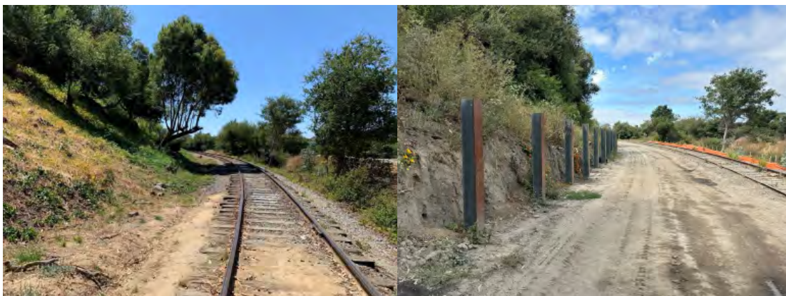
Construcción de la Fase 2 del Segmento 7 del Ferrocarril, Ciudad de Santa Cruz
