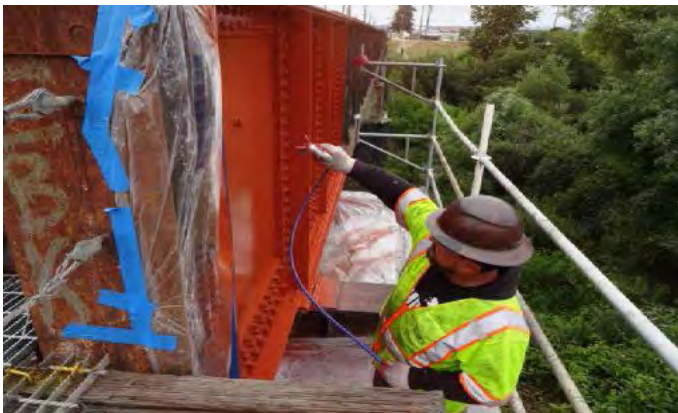
Las cuadrillas reforzaron y repintaron el acero estructural del puente del río Pájaro.
