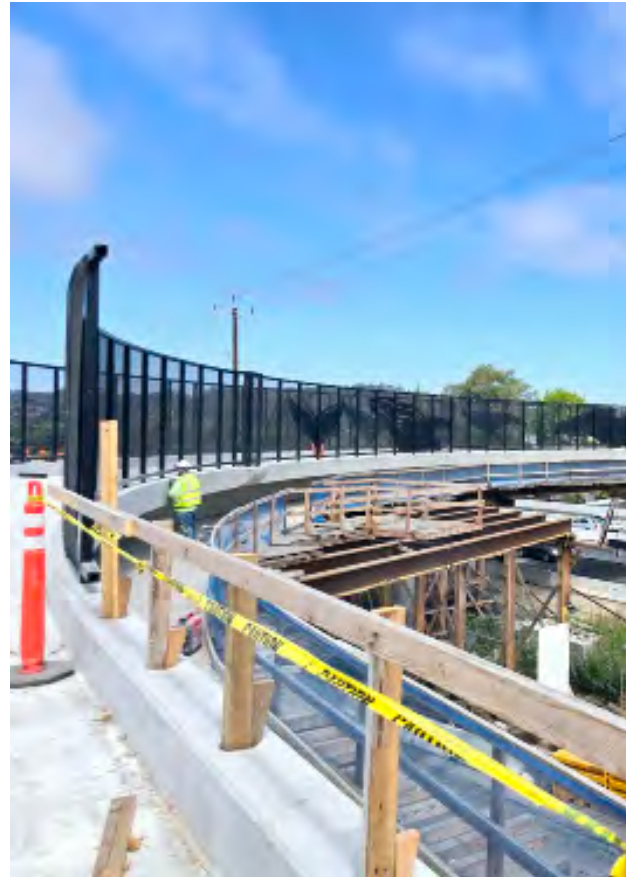
Construcción de un nuevo puente para peatones y bicicletas sobre la autopista 1 en Chanticleer Avenue.
